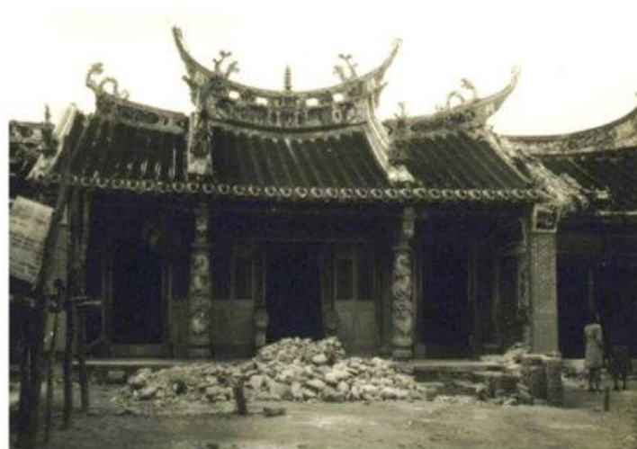
瑞美保安宮南北方向裂壞，向西攝。
