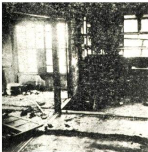
新港測候所宿舍損壞情形
